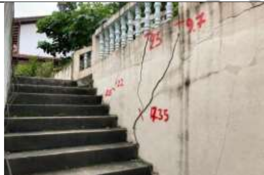
Fotografía 25: Grietas (e=15mm) del muro de contención frontal, colindante al socavón, IBI-07-13-50-000-000012, Inspección 29 de diciembre de 2021.
