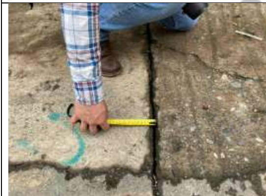
Fotografía 20: Grietas (e=12mm) de la calle E. A. Castro, frente al inmueble IBI-07-13-50-000-000047, Inspección 29 de diciembre de 2021.
