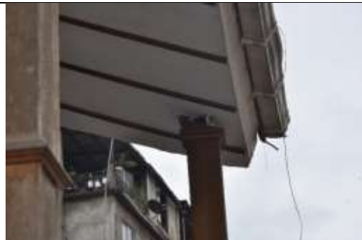
Fotografía 23: Estado actual del pilar IBI-07-13-50-000-000012, Inspección 29 de diciembre de 2021.
