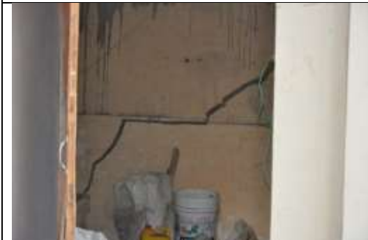
Fotografía 24: Grietas (e=20mm) muro portante lateral, colindante al socavón, IBI-07-13-50-000-000012, Inspección 29 de diciembre de 2021.
