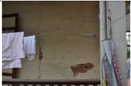
Fotografía 17: Grietas (e=12mm) de mampostería exterior del inmueble IBI-07-13-50-000-000047, Inspección 29 de diciembre de 2021.
