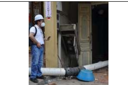
Fotografía 29: Colapso del sistema eléctrico del Inmueble IBI-07-13-50-000-000047, Inspección 29 de diciembre de 2021.
