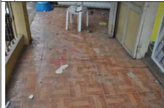
Fotografía 18: Grietas (e=10 mm) en el portal del inmueble IBI-07-13-50-000-000047, Inspección 29 de diciembre de 2021.
