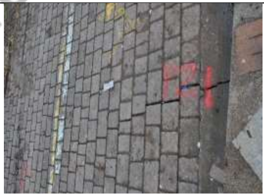
Fotografía 21: Grietas (e=12mm) de calzada de la calle Colón, frente al inmueble IBI-07-13-50-000-000047, Inspección 29 de diciembre de 2021.
