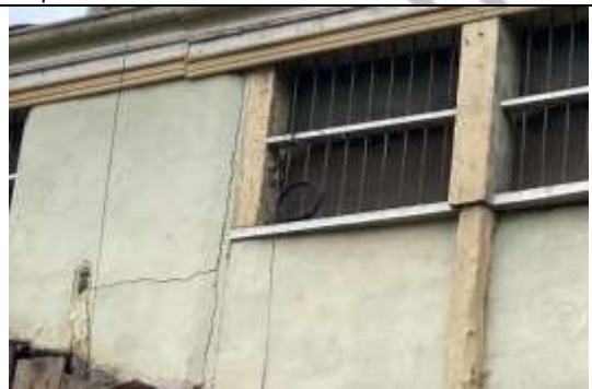
Fotografía 19: Grietas (e=10 mm) en el portal del inmueble IBI-07-13-50-000-000047, Inspección 29 de diciembre de 2021.
