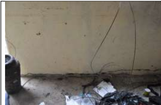
Fotografía 16: Grietas (e=10mm) de mampostería interior del inmueble IBI-07-13-50-000-000047, Inspección 29 de diciembre de 2021.
