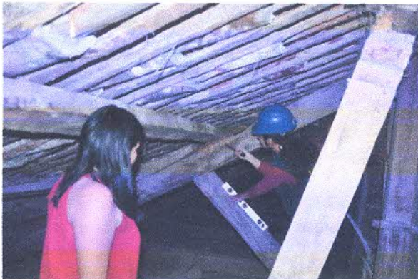
Fotografía N° 3: Estado de la estructura de madera de la cubierta
