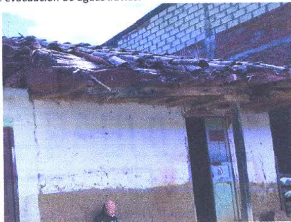
Fotografía nro. 5: Faltante de pilar de madera de portal influye en el colapso paulatino de cubierta
