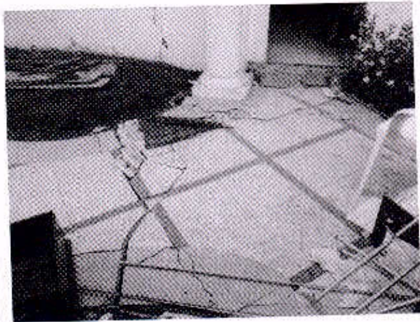
FOTO 2. Evaluación de daños del contenedor
