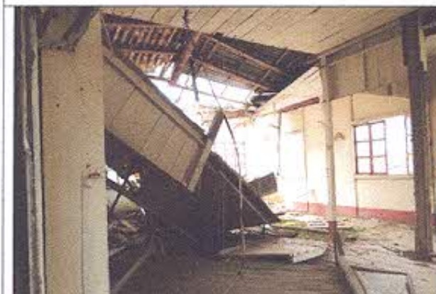
Fotografía 5: Colapso parcial de estructuras de cubierta del inmueble IBI-07-03-51-000-000002. Parroquia Ayapamba.
